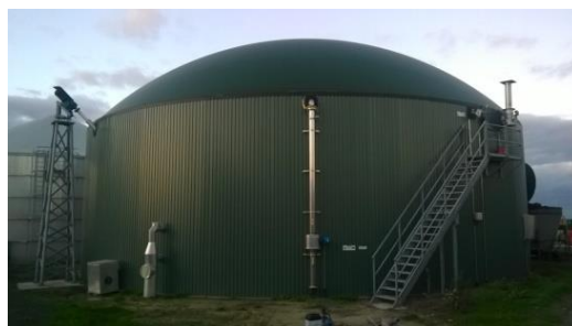
Le digesteur. ©Marion Delesalle/Agro-Transfert
